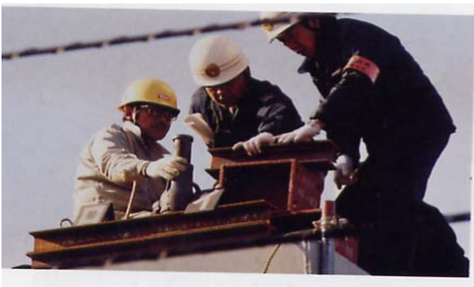
写真 3 : 補強リブの入っていない H 型鋼 ( 出典 : 日経コンストラクション編 : 建設事故 p 1 6 )
